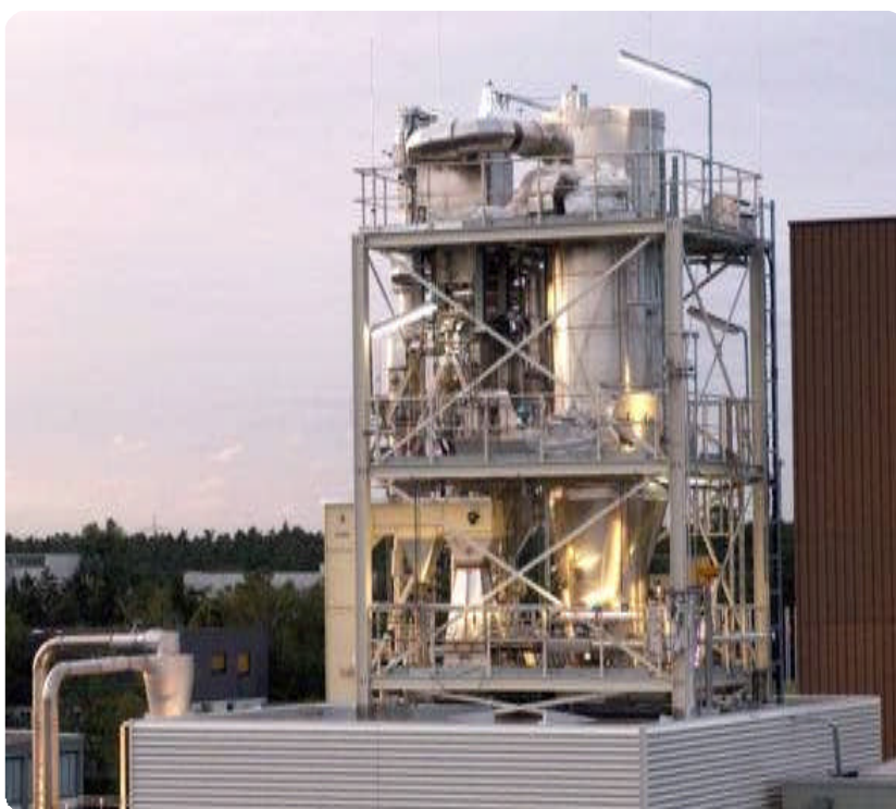
Unité pilote de pyrolyse à Karlsruhe (Allemagne)
